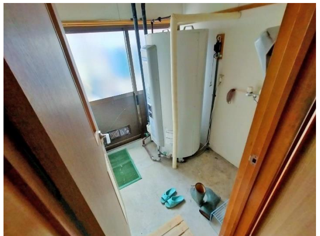
1階 勝手口、電気温水器
