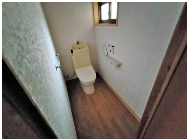
車庫1階 トイレ
