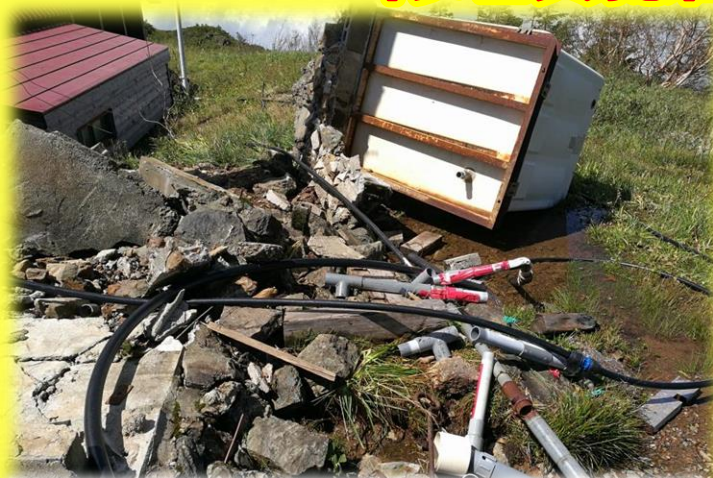
土台のコンクリート共々吹き飛ばされたタンク
