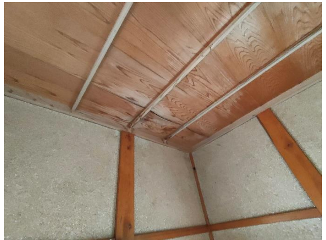
1階 和室6帖 天井雨漏り跡
