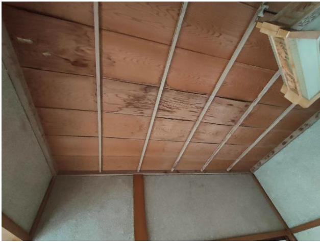
1階 和室6帖 天井雨漏り跡
