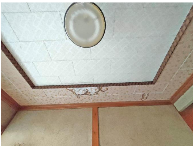
1階 玄関 天井雨漏り跡
