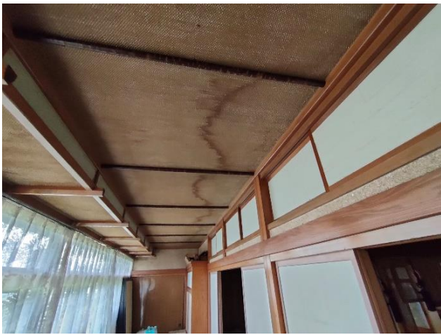
1階 縁側 天井雨漏り跡
