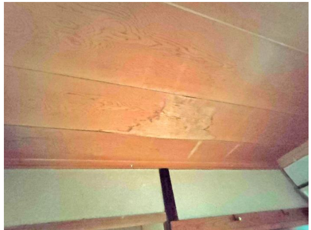
1階 和室8帖 天井雨漏り跡
