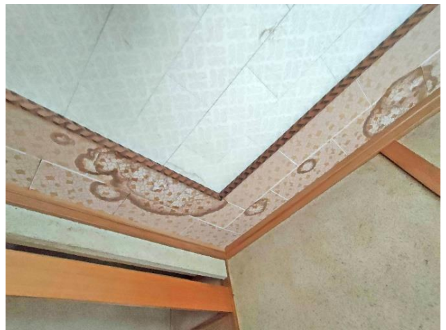
1階 玄関 天井雨漏り跡
