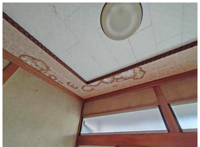
1階 玄関 天井雨漏り跡
