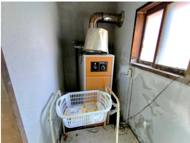
1階 脱衣スペース・ボイラー置き場
