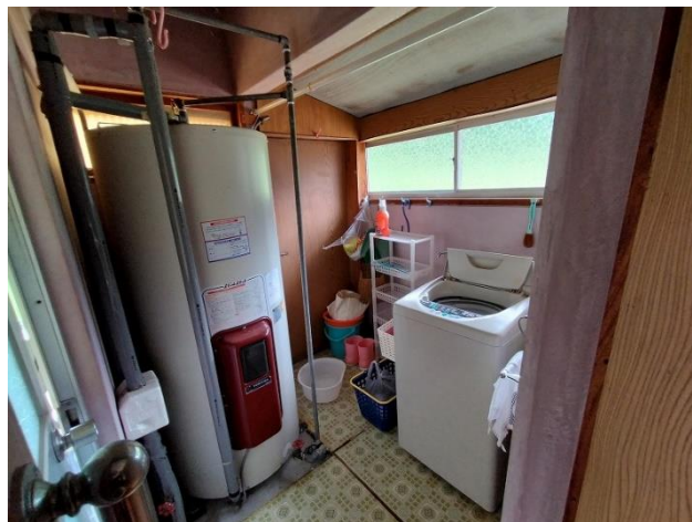
1階 電気温水器/洗濯機置き場
