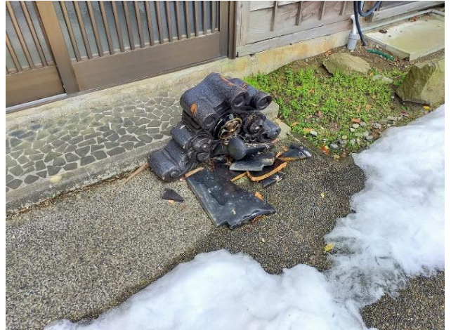
落下した玄関屋根の鬼瓦
