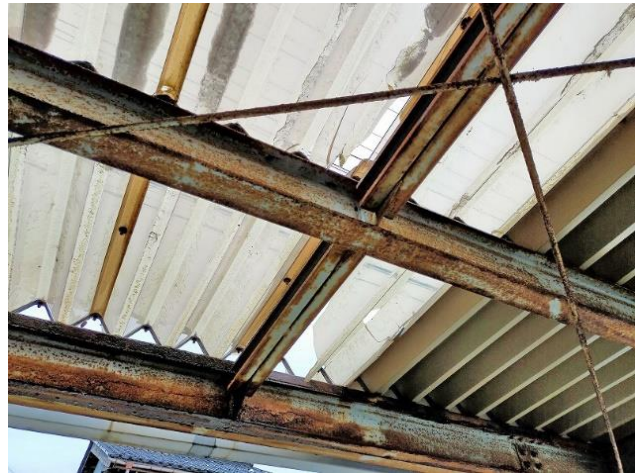
駐車場屋根の破損状況
