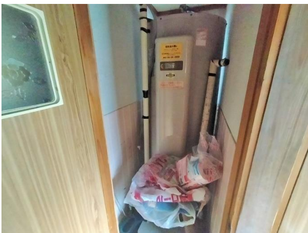
1階 電気温水器
