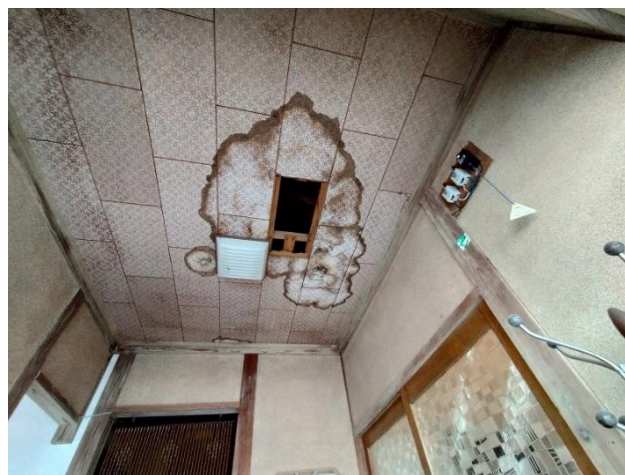
玄関天井 雨漏り跡
