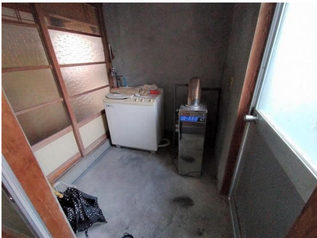
1階 洗濯機置き場、灯油ボイラー
