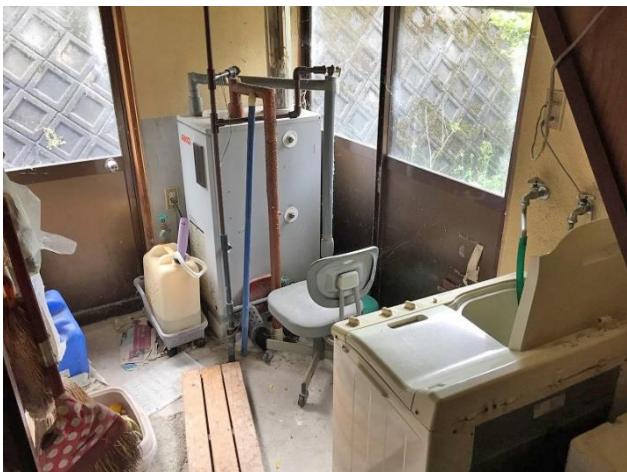
1階 洗濯機置き場・ボイラー・勝手口
