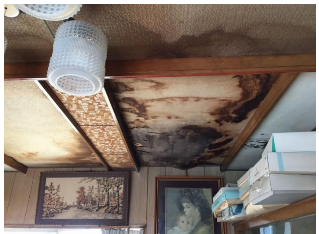
雨漏り跡 (洋室10帖) ※屋根は補修済み
