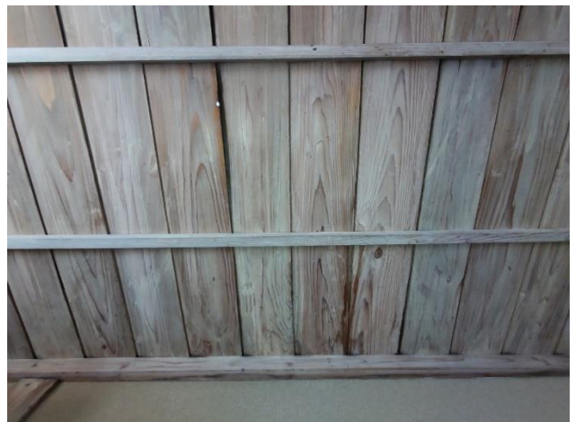
2階 和室 4.5帖天井の雨漏り
