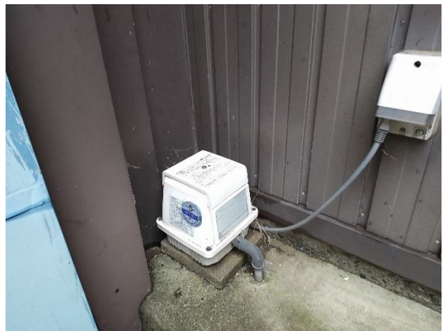
浄化槽のブロワー
