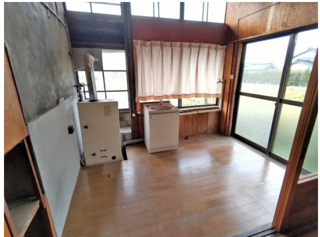
1階 ボイラー置き場
