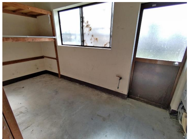
1階 ボイラー室
