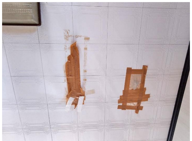
2階 洋室10帖 天井 雨漏り跡
