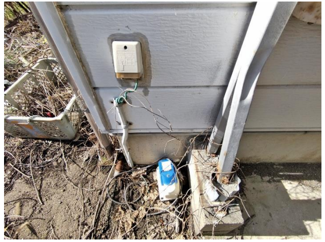
浄化槽ブロー
