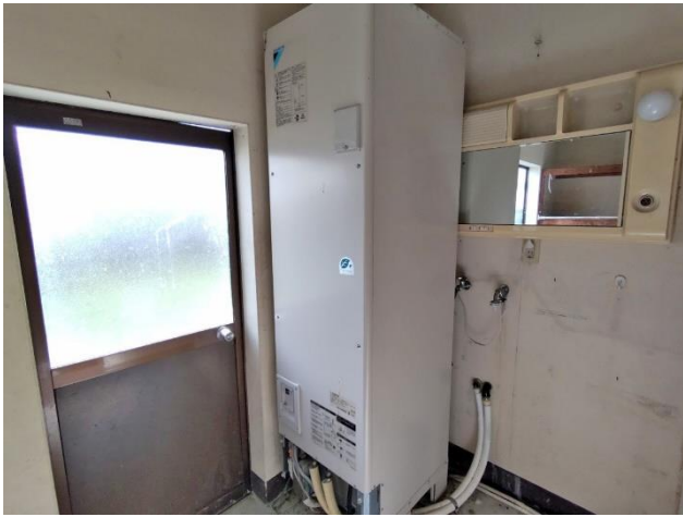
1階 勝手口、エコキュート
