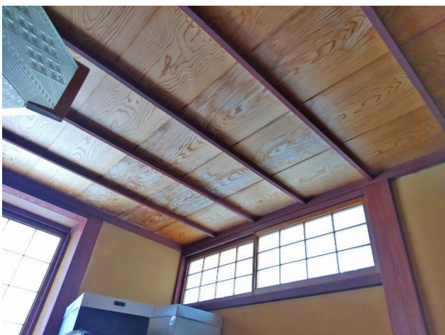
2階和室8帖の天井のシミ(雨漏り補修済)
