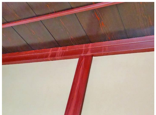
1階和室6帖の柱のシミ(現在雨漏りなし)
