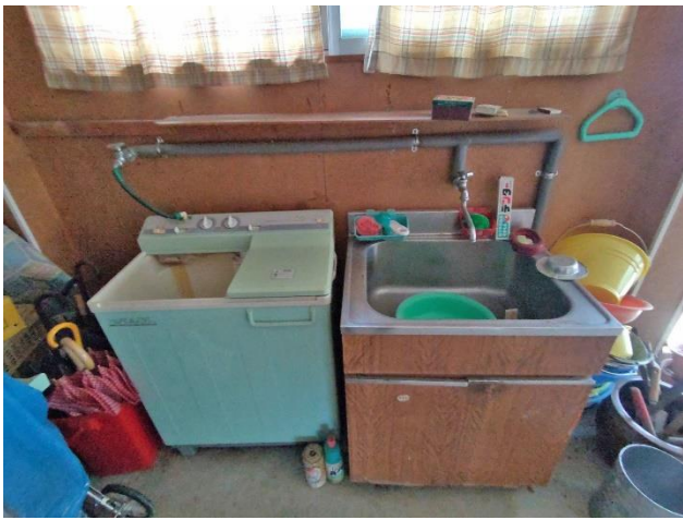
1階 納屋内 水道
