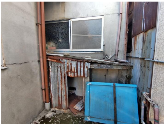
井戸ポンプ、プロパンガス置き場
