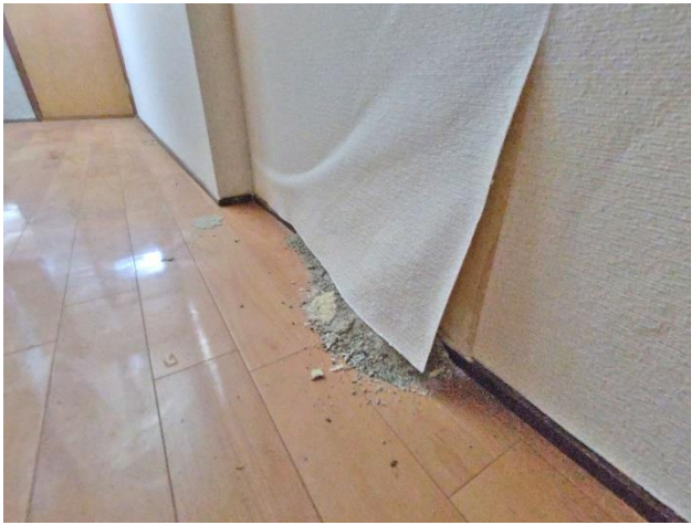
1階 廊下壁崩れ
