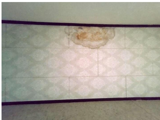
1階 廊下天井雨漏り跡
