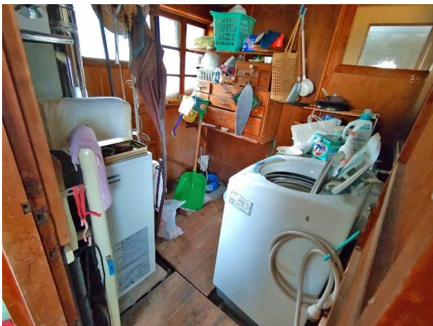
1階 ボイラー室
