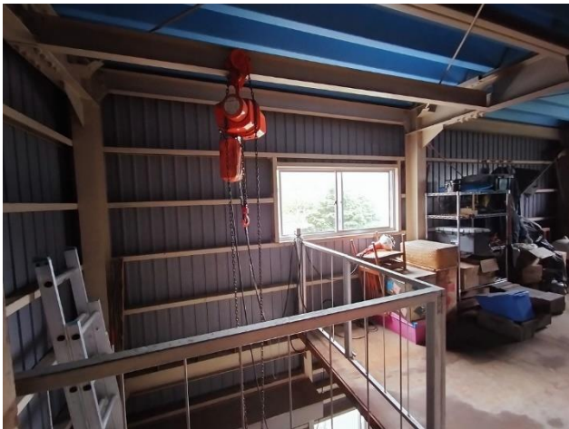
車庫兼作業場（2階）クレーン
