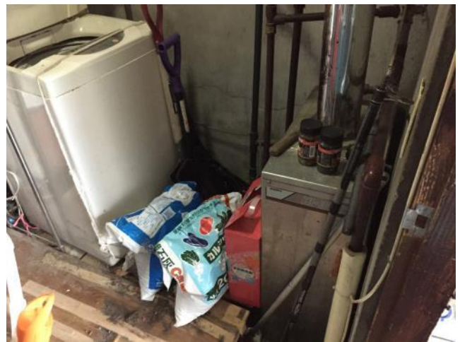
1階 洗濯機、ボイラー置場
