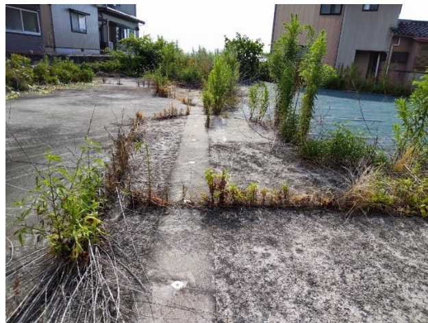
敷地手前 消雪設備状況
