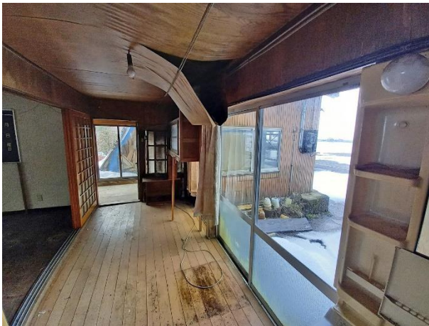
1階 廊下 (雨漏り状況)
