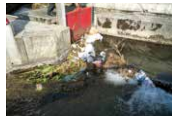
刈り草、ごみの不法投棄により水路が詰まっている様子
