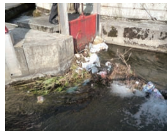
刈草、ごみの不法投棄により水路が詰まっている様子
