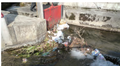
(刈草、ごみの不法投棄により水路が詰まっている様子)
