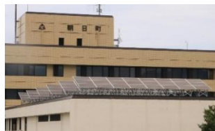
▲太陽光発電設備（役場庁舎） 2021年導入
