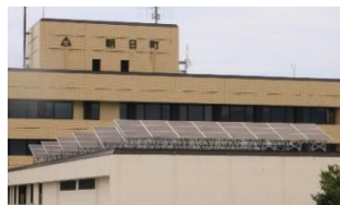
▲太陽光発電設備（役場庁舎） 2021年導入
