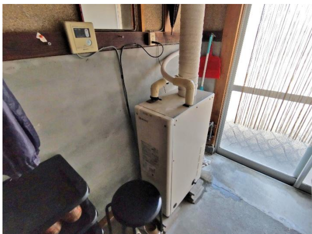
Ⅰ階 灯油ボイラー
