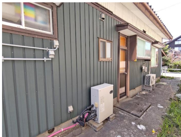
灯油ボイラー、旧勝手口
