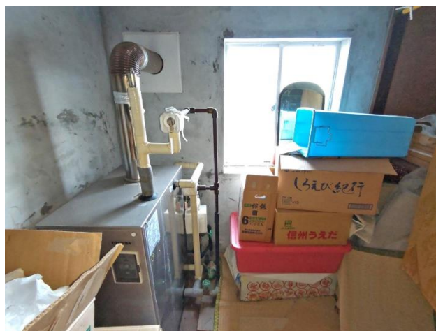
納屋 1階 灯油ボイラー
