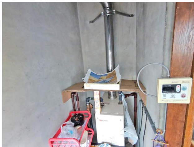
1階 灯油ボイラー
