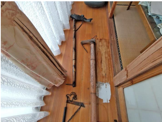
1階 縁側 A・雨漏り跡
