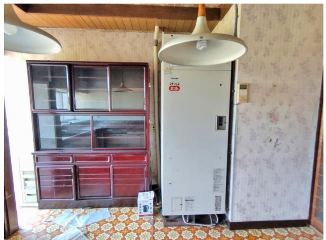
1階 台所、電気温水器
