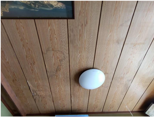
1階 和室6帖Bの天井雨漏り跡
