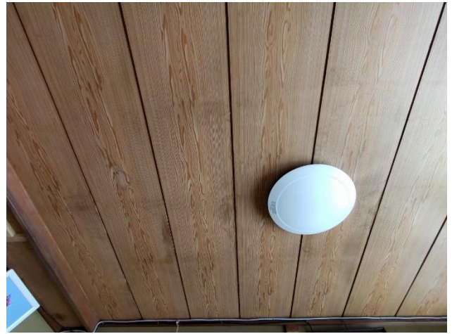
1階 和室6帖Cの天井雨漏り跡
