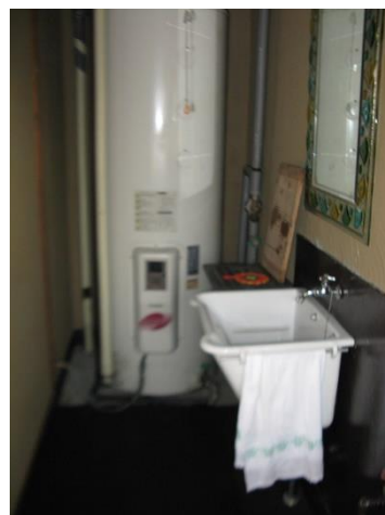
1階 ボイラー室
