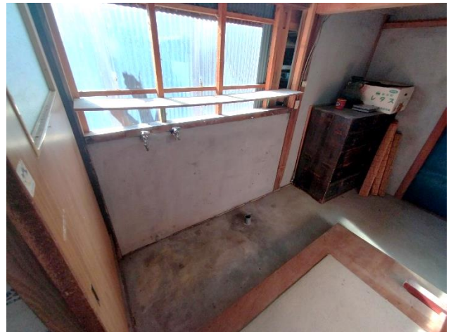
1階 洗濯機置き場
