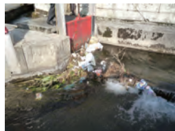
刈り草、ごみの不法投棄により水路が詰まっている様子
