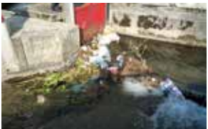
刈り草、ごみの不法投棄により水路が詰まっている様子
