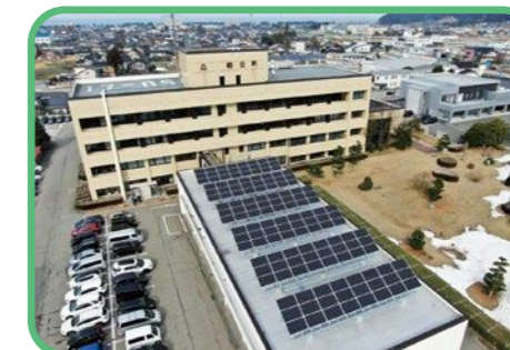
太陽光発電（朝日町役場庁舎）
