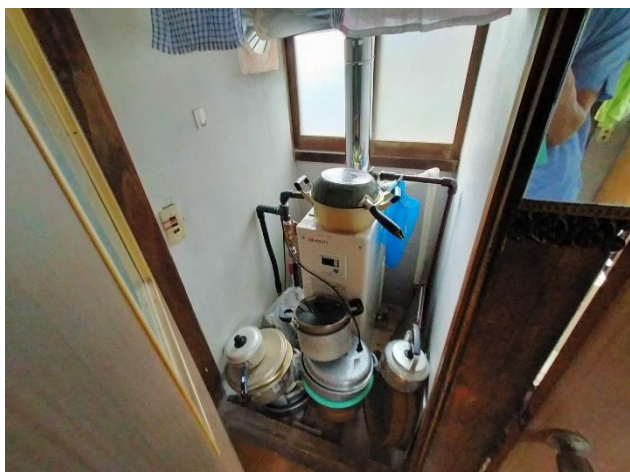
Ⅰ階 ボイラー置き場
