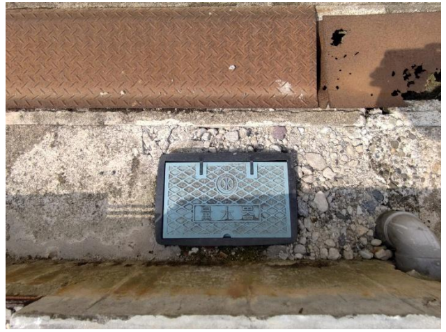
水道メーター
