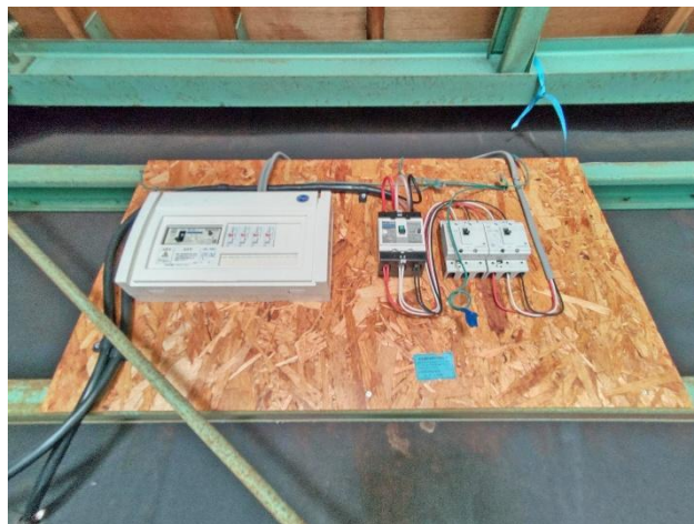
車庫1階 配電盤
