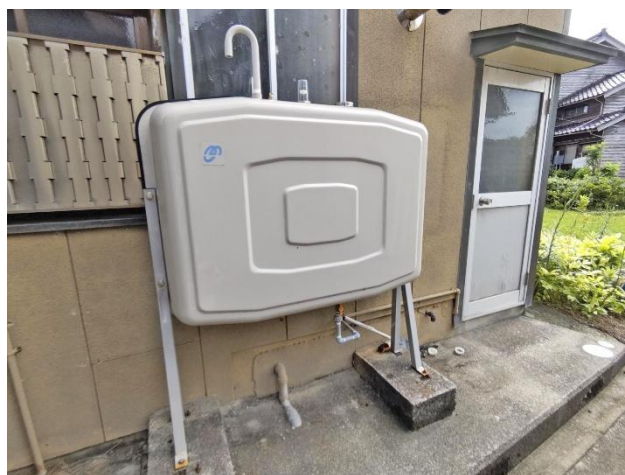
灯油ボイラー、勝手口
