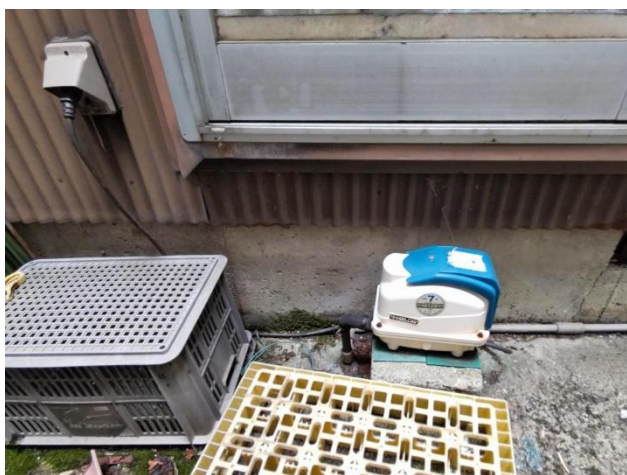
浄化槽ブロワー
