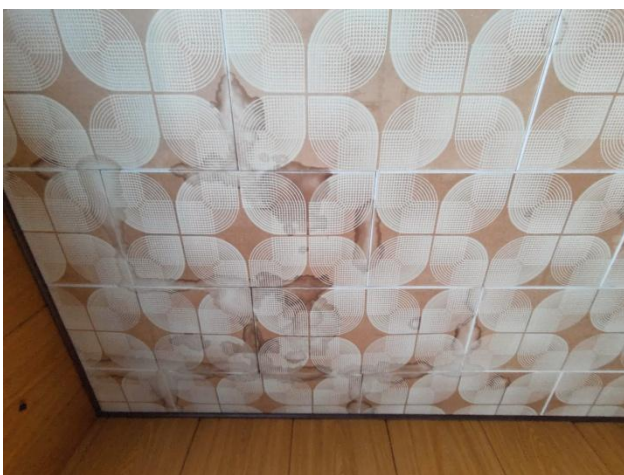
2階 洋室8帖 天井雨染み跡
