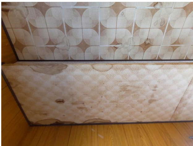
2階 洋室6帖 天井雨染み跡
