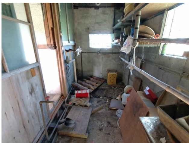
Ⅰ階 ボイラー室
