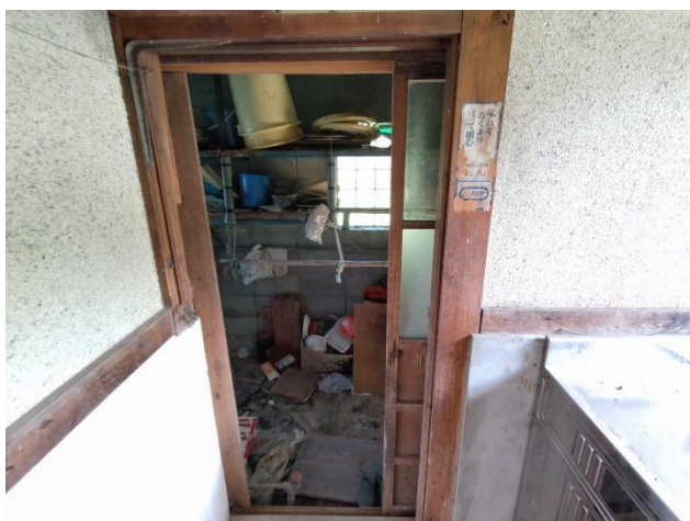
Ⅰ階 ボイラー室入口
