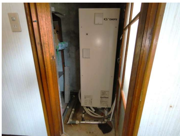
Ⅰ階 ボイラー室
