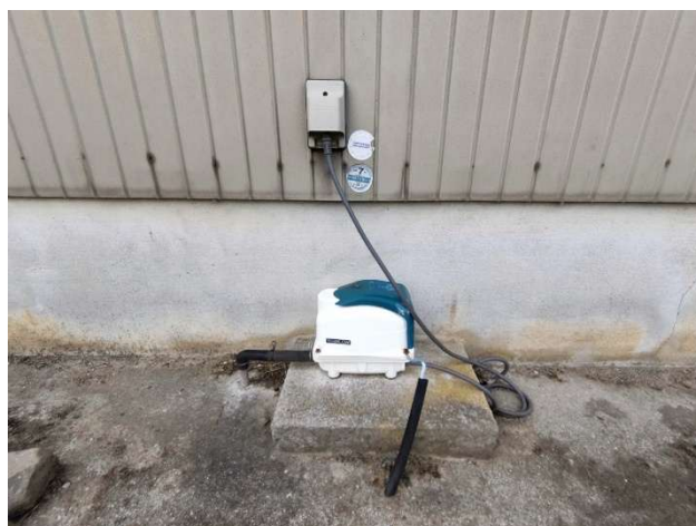
浄化槽ブロー
