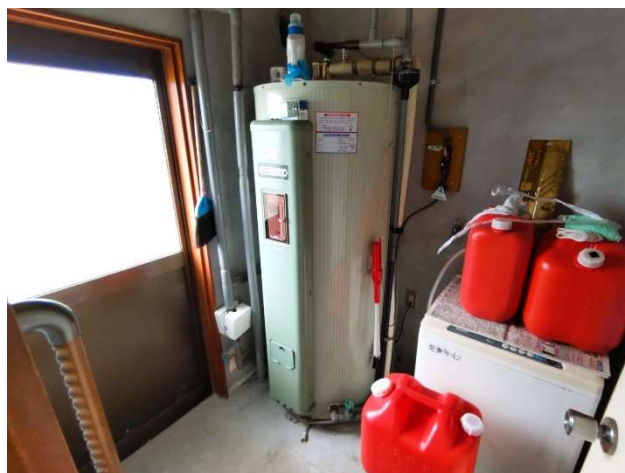
Ⅰ階 ボイラー室
