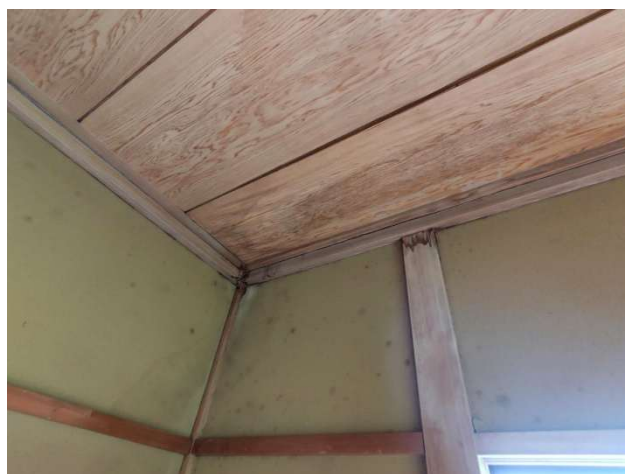
2階 和室6帖C 天井雨染み跡
