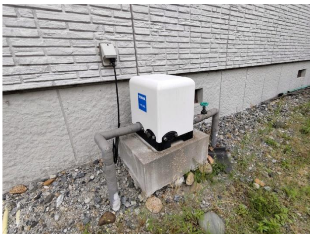
自家井戸ポンプ
