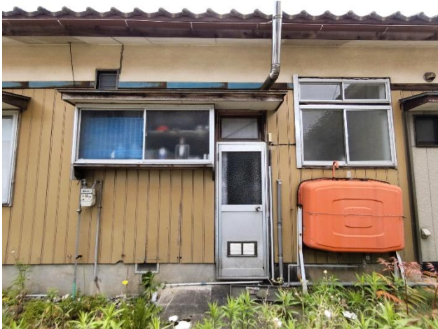
プロパンガス置き場、勝手口、灯油タンク
