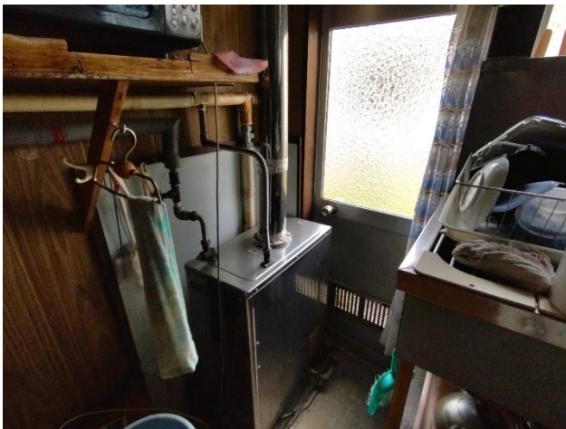
1階 灯油ボイラー、勝手口
