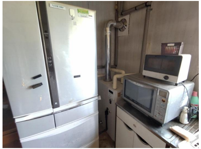
1階 台所 灯油ボイラー
