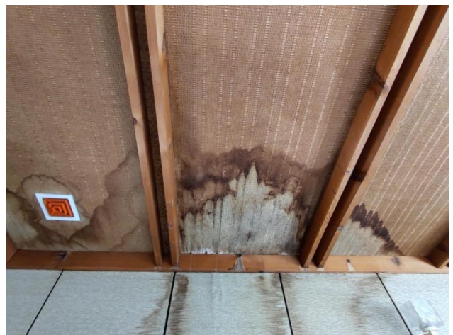
2階 洋室10帖 天井染み
