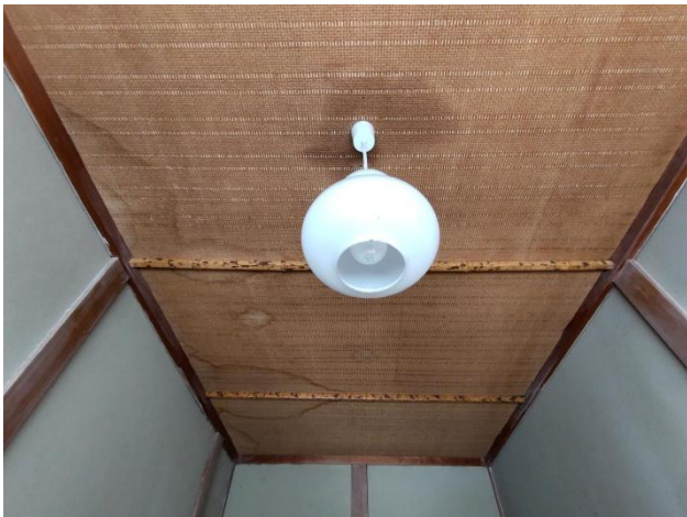
2階 階段 天井染み
