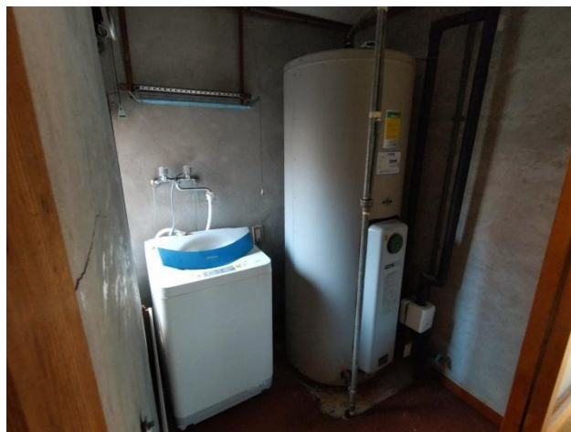
1階 洗濯機置き場、電気温水器
