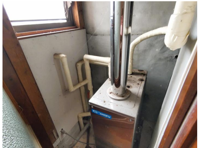
1階 灯油ボイラー
