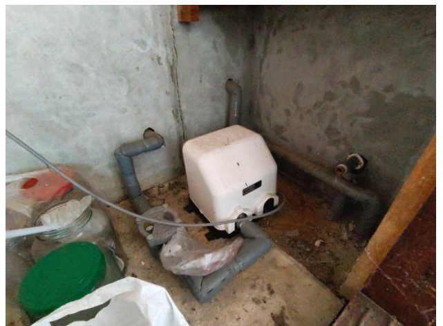
1階 自家井戸ポンプ
