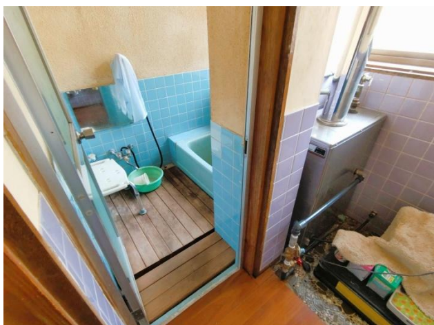
Ⅰ階 風呂入口、灯油ボイラー
