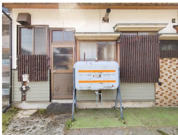
灯油ボイラー
