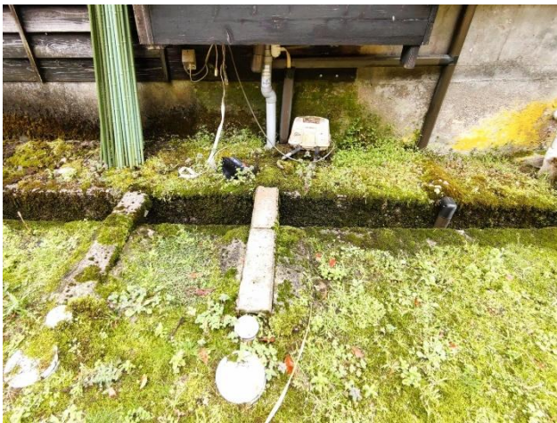
浄化槽ブローワー
