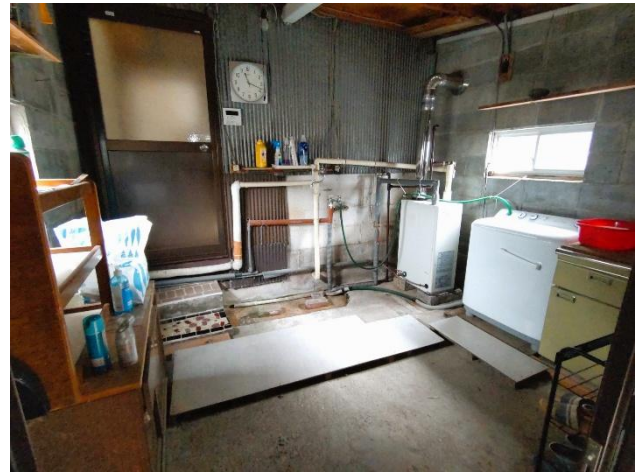
1階 ボイラー室 (別角度)
